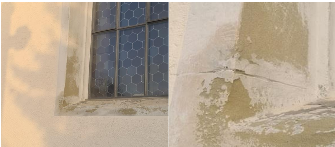
Mittleres Fenster, Berner Sandstein, im unteren Bereich ist die Farbe stark verwittert. Teilweise sind defekte Stellen ersichtlich.
